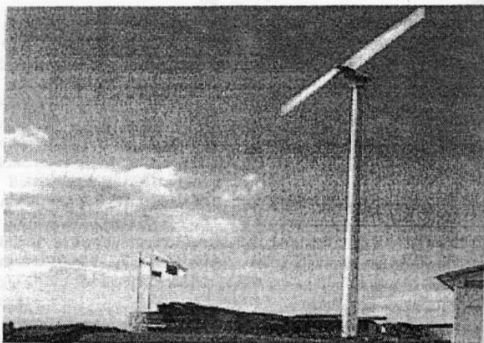
Zīm. 4.3. Vēja ģenerators neliela ražojoša uzņēmuma elektroapgādei
